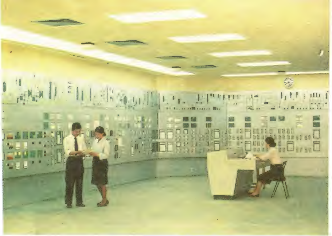
공장의 조종실 Control Room of a Factory
